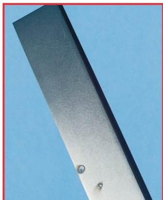
Коррозия на долоте
