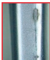
Фрагмент контактной коррозии
